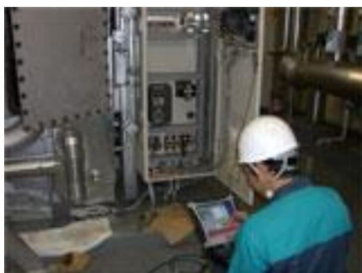
<吸収式冷温水機データ採集>
