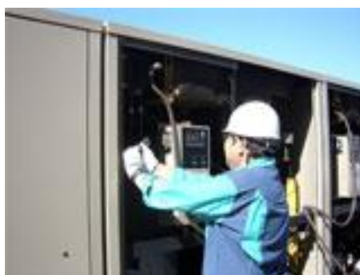
<吸収式冷温水機点検中>
